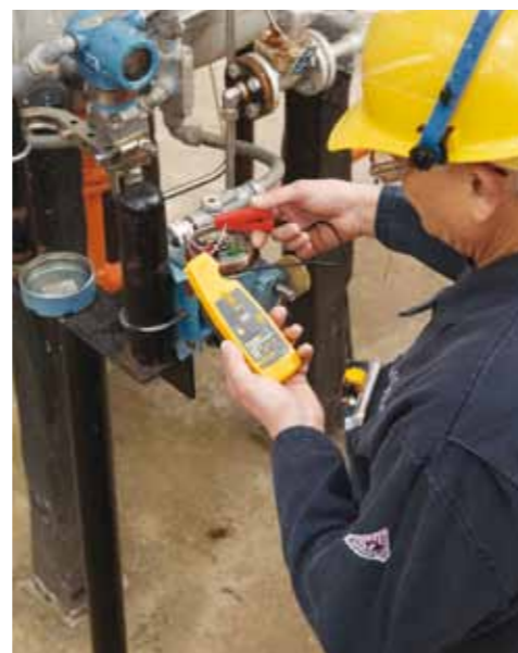
mA-Messung ohne Unterbrechung der Schleife mit Fluke 771
