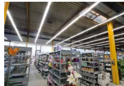
Die neue Beleuchtungsanlage der Lagerhalle wurde mit Siteco Mondario Lichtbändern mit Multi-EVG 35/49/80 W ausgeführt.
